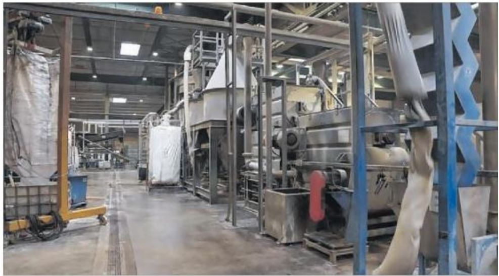
Durch die Änderung des Lichtkonzepts und der Nutzung von Abwärme wird zum Beispiel bei der PET-Recycling-Anlage von Fetzer in Eislingen Energie und Geld gespart. Nach gut einem Jahr haben sich die Investitionskosten gerechnet.
